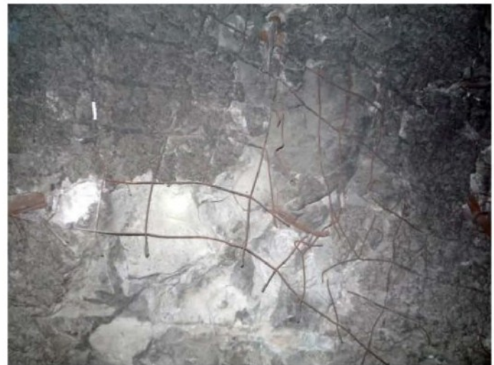
Рис. 3. Отслоение набрызг-бетона и пород в горных выработках медистых руд
